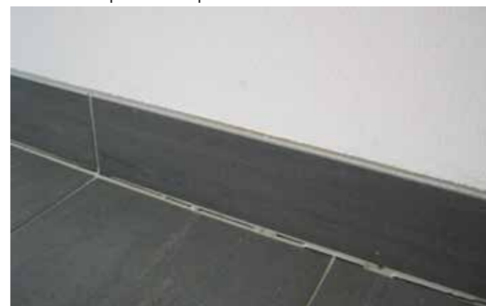
Obr. 31 – Potrhaná dilatační spára bez použití separačního provazce
